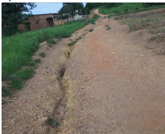
Traversée d'agglomération avec zone érodée
